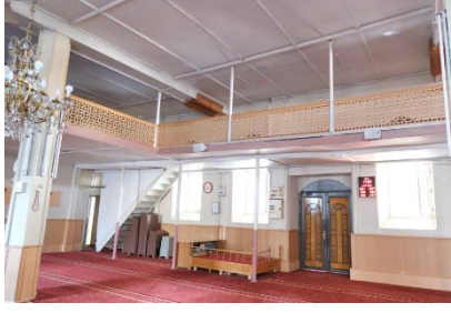
Fotoğraf 3: Tahtalı Minare Camii kadınlar mahfili ve kontrplak kaplı ahşap tavan
